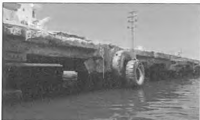
Figura 3.5-5 – Imagen de daños en placas de apoyo defensas del Muelle 1
