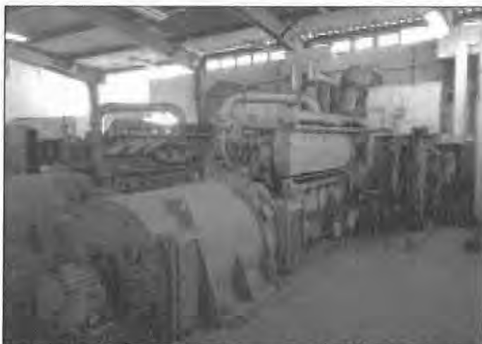
Figura 3.5-18 – Vista del sistema eléctrico del Terminal Portuario Salaverry
