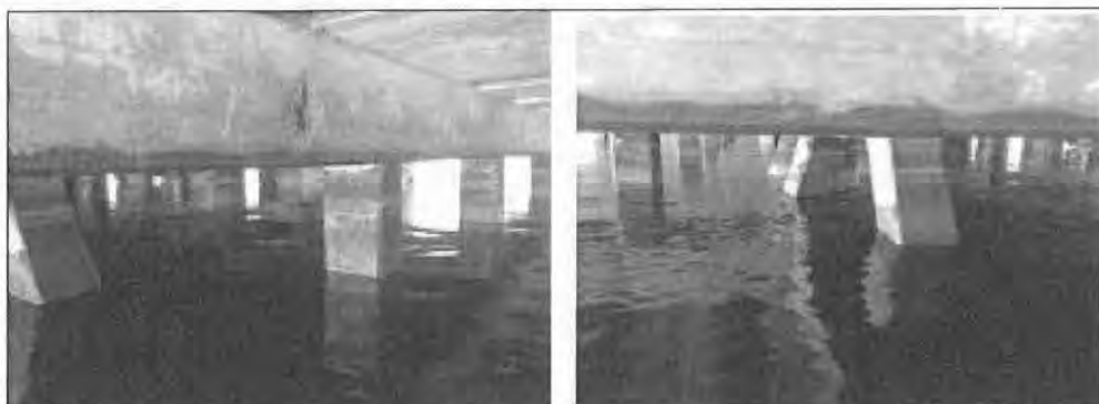
Figura 3.5-7 – Imagen de las condiciones de las Vigas cabezales del Muelle 2
