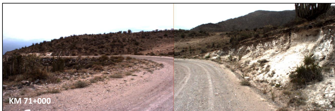
Imagen 3: Suelo con subrasante con potencial de hinchamiento
